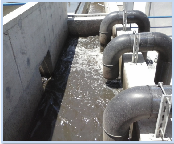
Figures 20: Bassin de recirculation des boues
