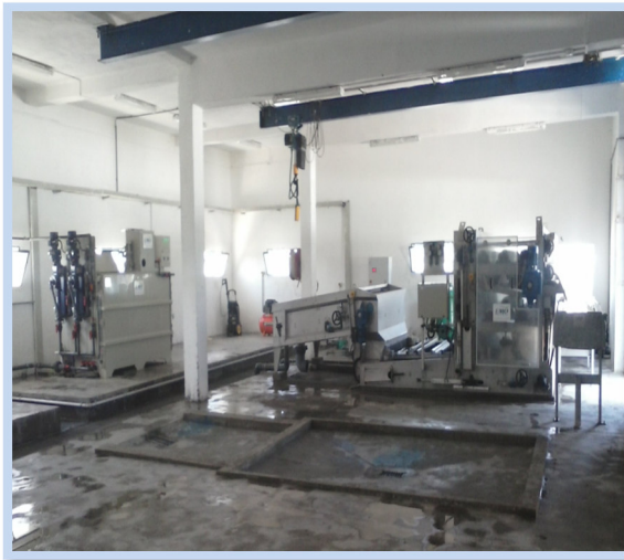
Figure 22: Bloc de déshydratation des boues
