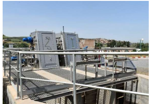
Figure 10 : Dégrilleur fin automatique (16/04/2017)
