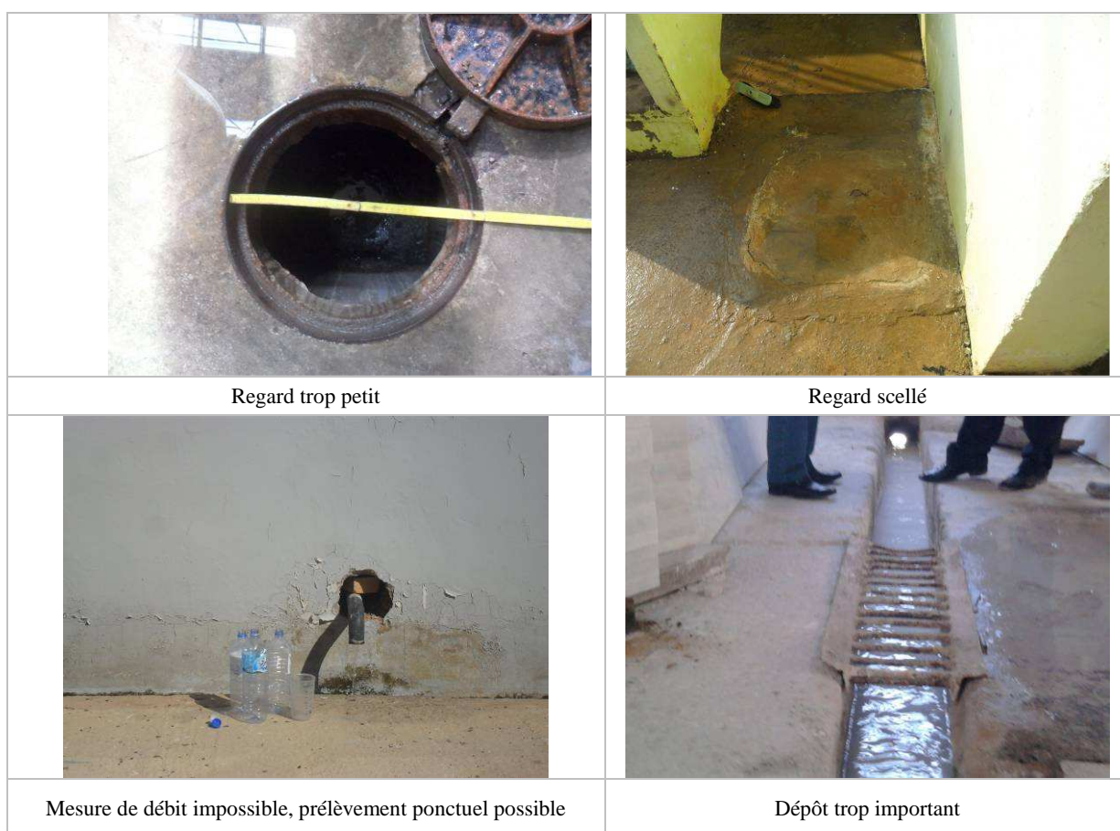
Figure 6: Planche photographique – Difficultés d'installation rencontrées
