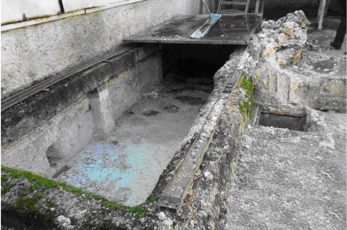
Figure 21 : bac de dégraissage existant au niveau de SOCOV
