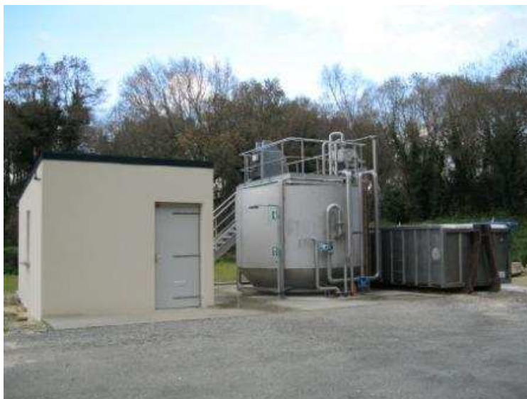
Figure 20: exemple d'installation de traitement physico-chimique par flottation (entreprise TALLEC – Finistère – France)
