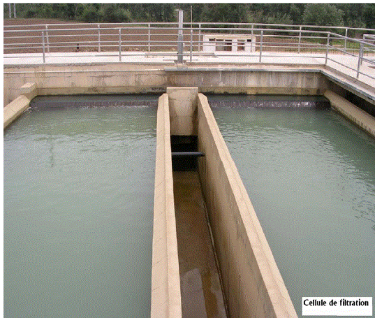
Cellule de filtration
