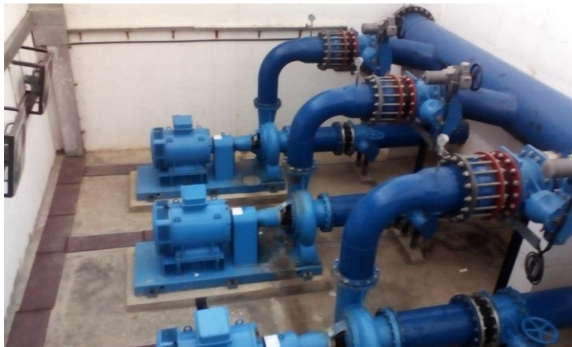
FigureII.2 : Photo de la Salle des pompes [19].
