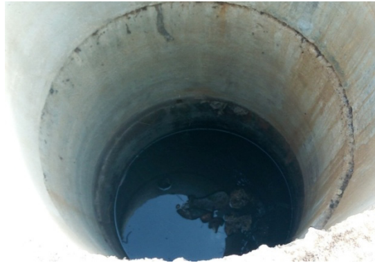
figure 57: lixiviat dans les ouvertures de l'ancien casier.
