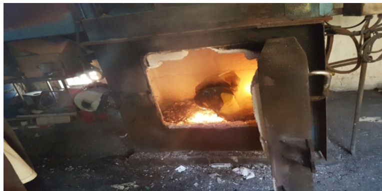
Photo 15: Chambre de combustion des déchets hospitaliers
