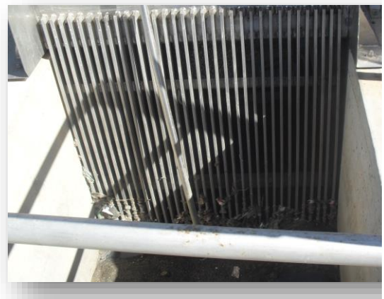
Photo 05: Le dégrilleur manuel (photo originale Mayouf/Boutrig).
