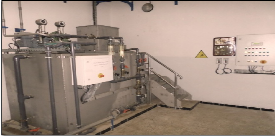
Figure 12 : Poste de préparation de polymère (source : auteur)
