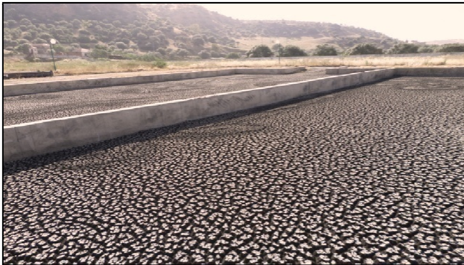
Figure 13 : Lits de séchage (source : auteur)
