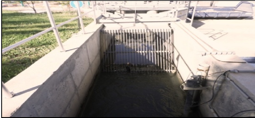
Figure 03: Dégrilleur grossier (source : auteur)
