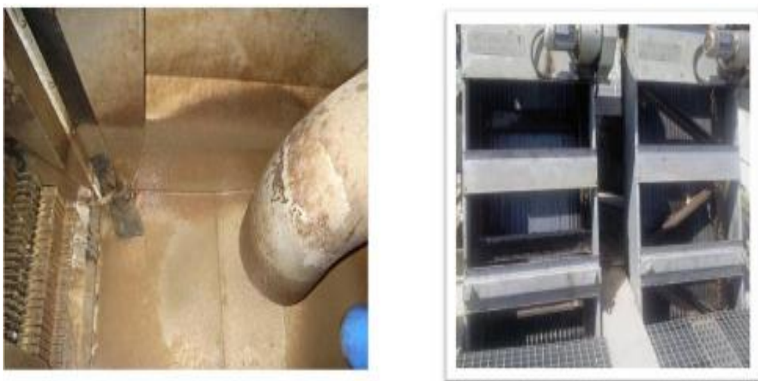
Figure 2: Photo d'une grille grossière et fine de STEP de Bouira (Photo original)
