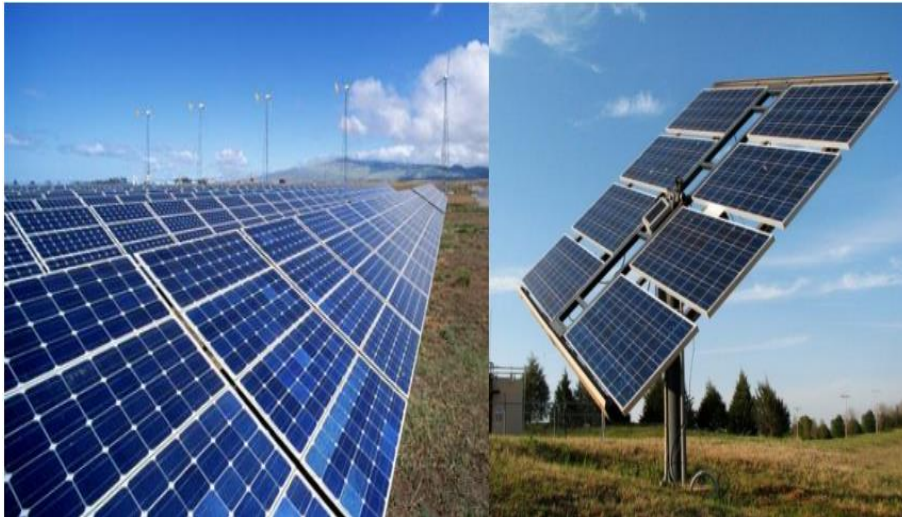
Figure I.6 : vue du panneau photovoltaïque.
