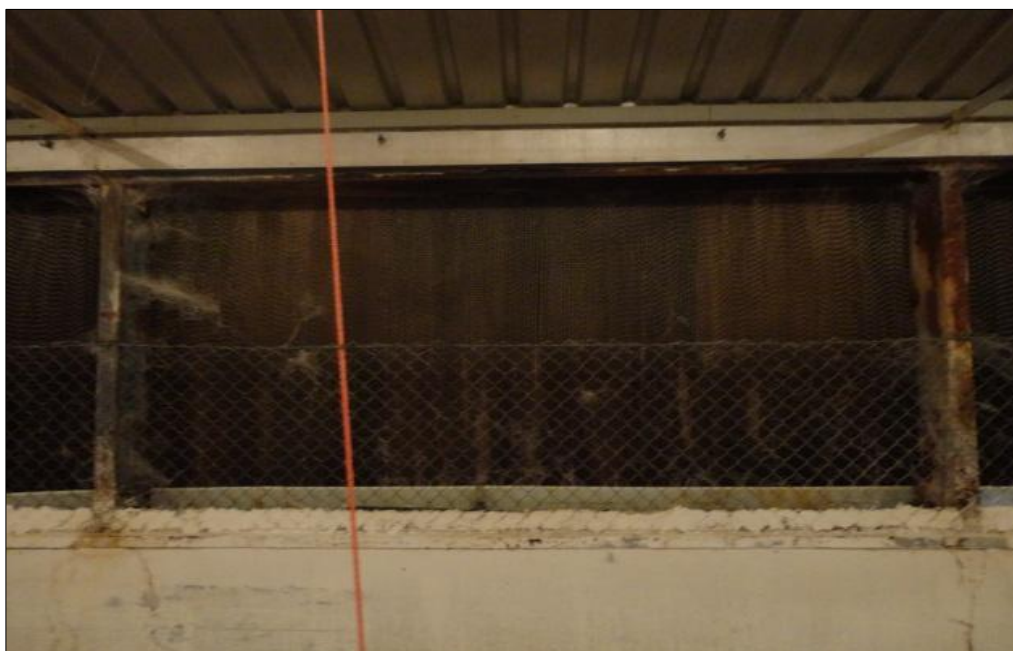
Figure 10: Exemple de Pad cooling équipant les bâtiments(photo personnelle).
