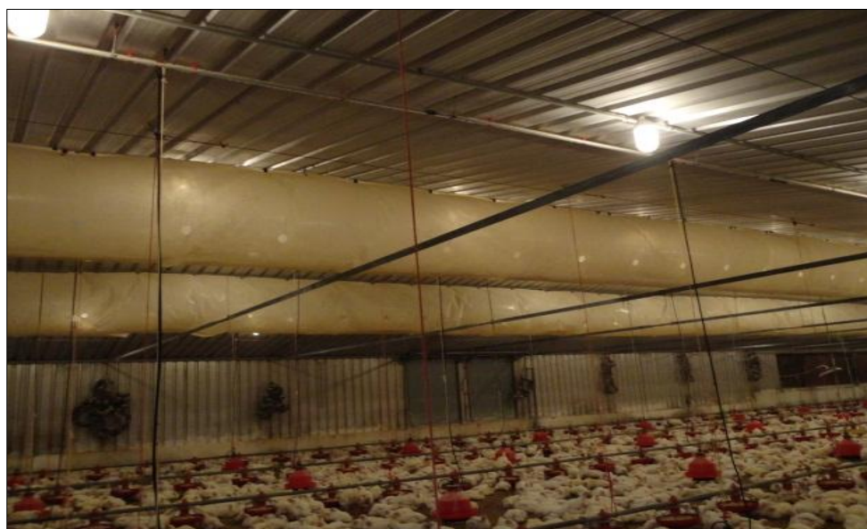
Figure 11: Vue de l'intérieur d'un bâtiment équipé de fan jet (photo personnelle)
