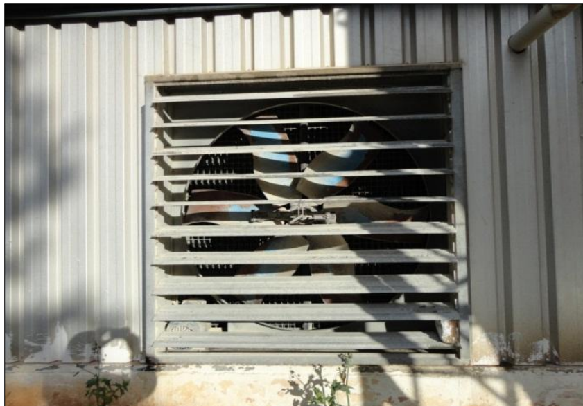
A : Vue extérieur d'extracteur du bâtiment (petit type, photo personnelle).
