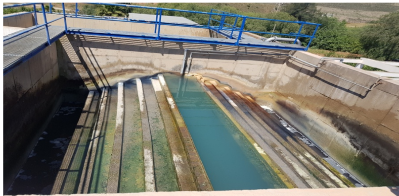
Figure 2.3 : la cascade d'aération.
