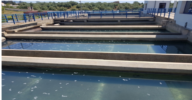
Figure 2.5 : Filtres à sable.
