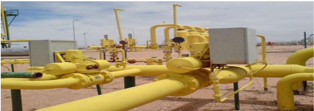
Figure III- 1 : Vanne d'Alimentation Collecteur ( TC , TA )
