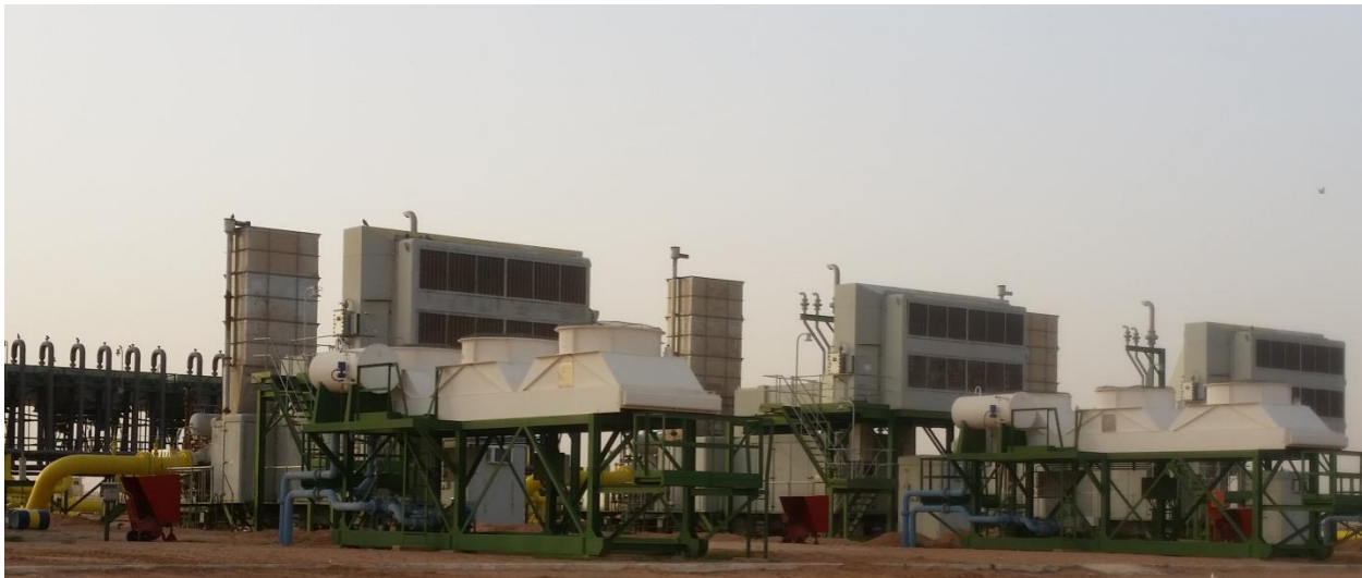
Figure II- 6 : SCB-vue d'ensemble des turbocompresseurs.
