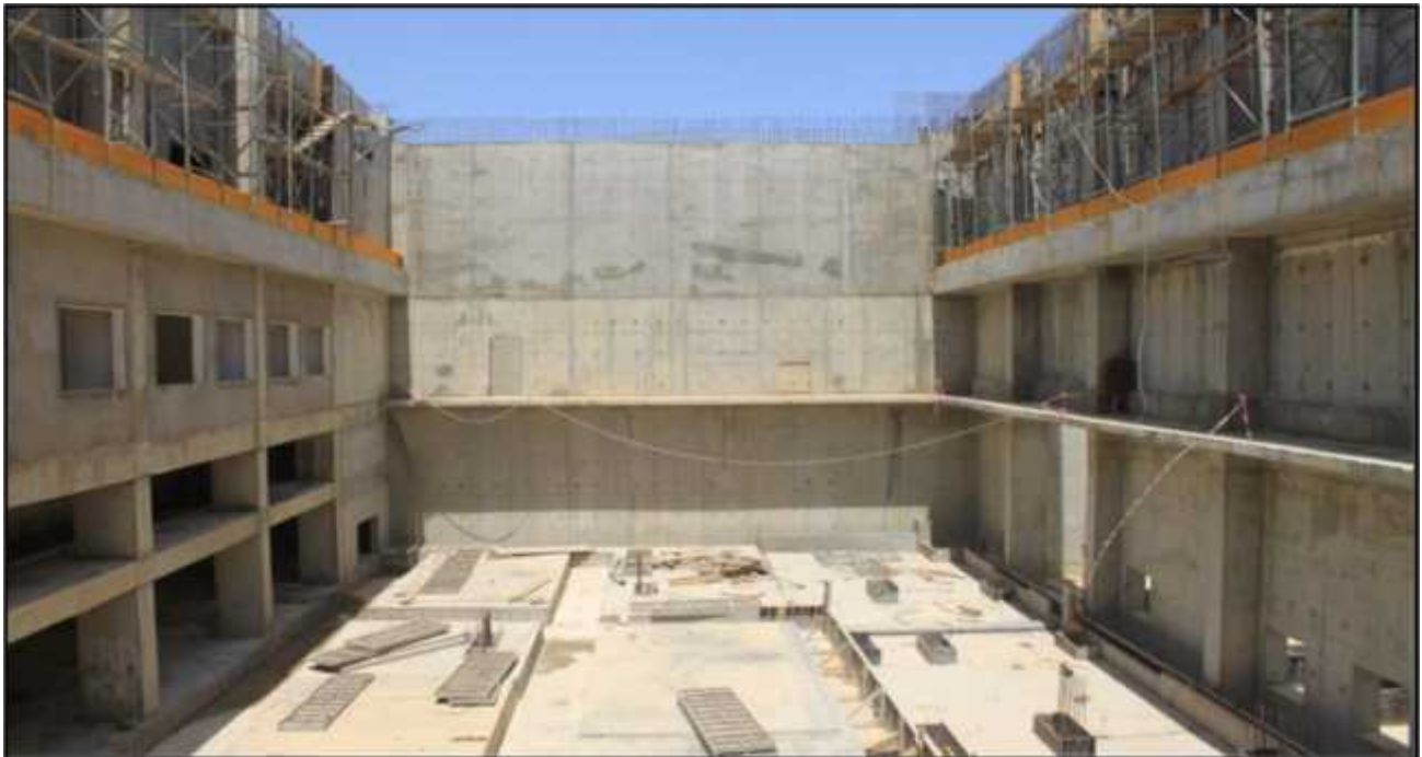
Figure 5 : l'intérieure de la station SR 2
