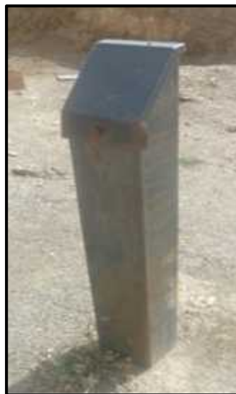
Figure 14 : Prise de protection cathodique
