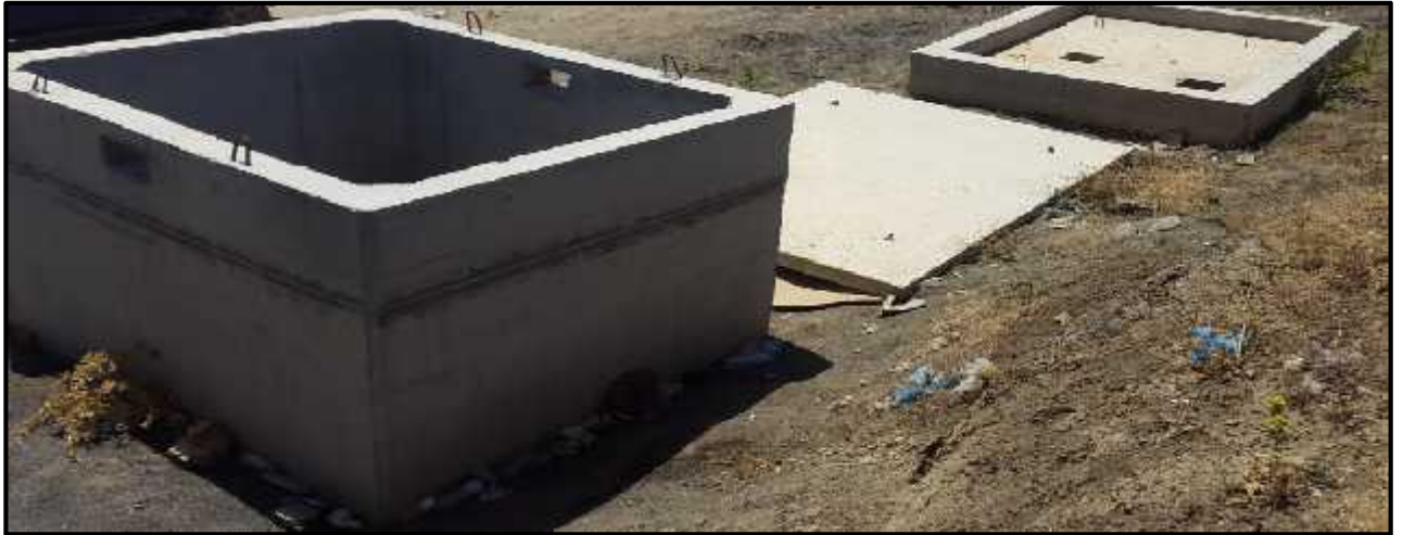
Figure 13: Chambre de vidange
