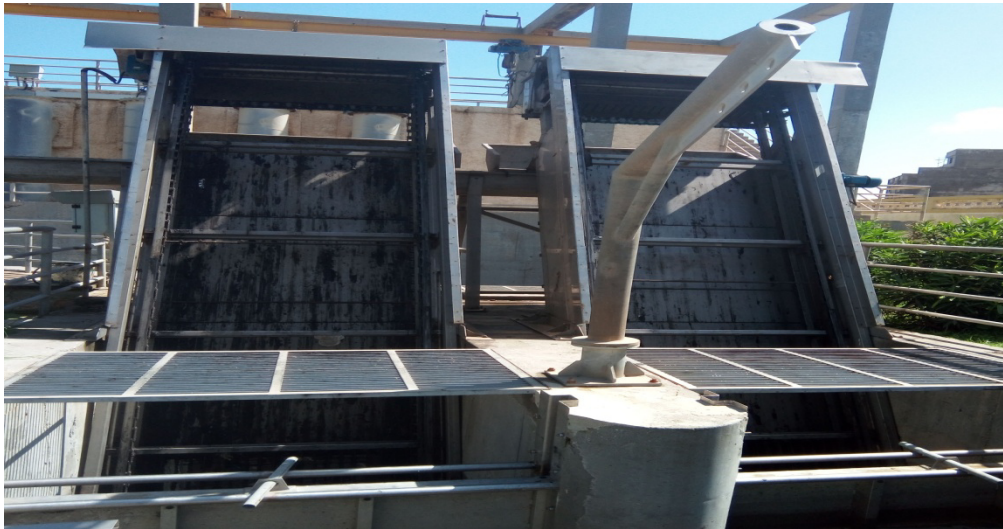
Figure. II.1. Les deux dégrilleurs grossiers automatiques.
