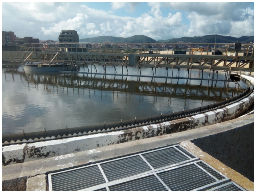
Figure. II .9.Le décanteur secondaire.
