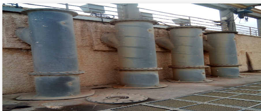
Figure. II.3 Les quatre pompes de relevage existants dans la station.
