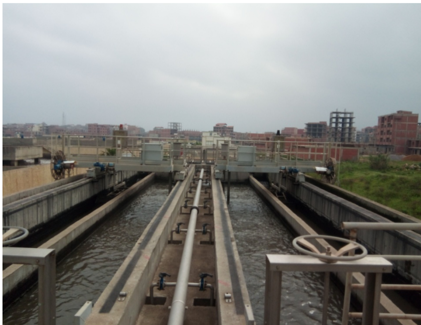
Figure. II.4.Les deux dessableur-déshuileurs de la station.
