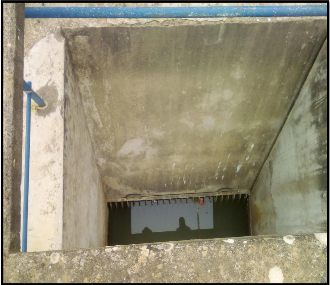
Figure 06: Dégrilleur moyenne à l'entrée de la station
