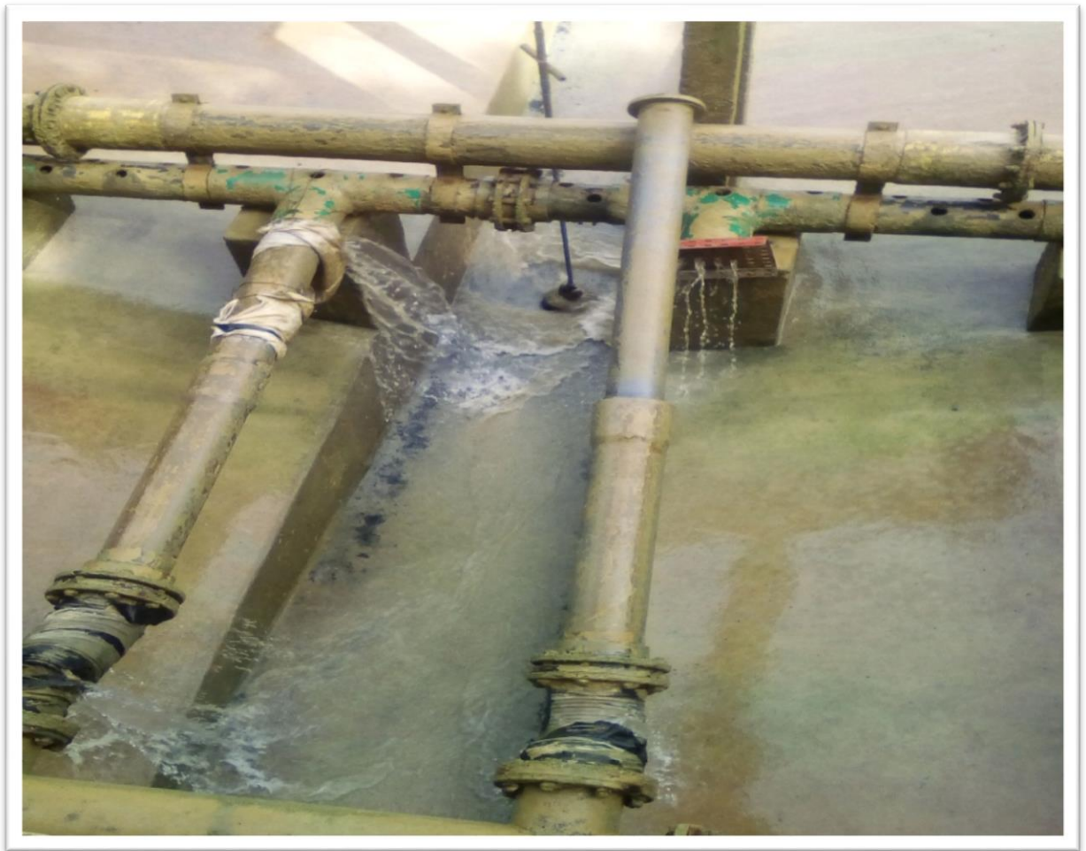
Figure 14 : Les fuites dans les flotteurs
