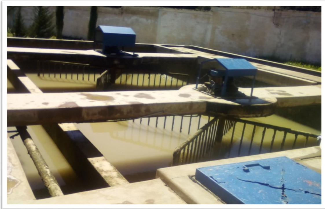
Figure 10 : Les bassins de floculation
