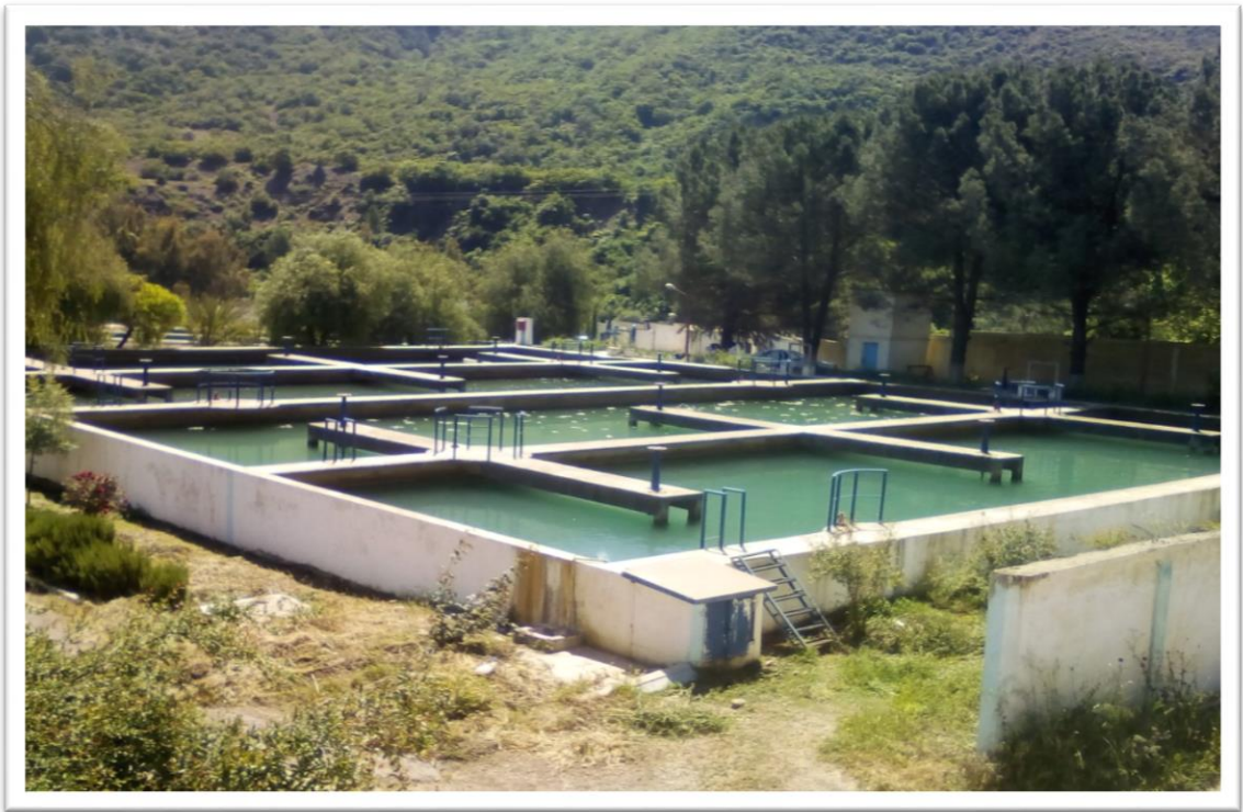
Figure 08 : Les bassins de débourbeur
