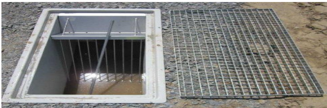
Figure 5 : dégrillage manuelle. (Techniciens, 2017)
