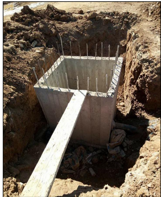
Figure V.8. Regard de vanne
