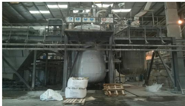
Figure I.6: Unité de silicate de sodium
