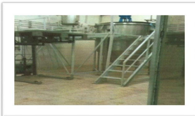
Cuve de 3000l
