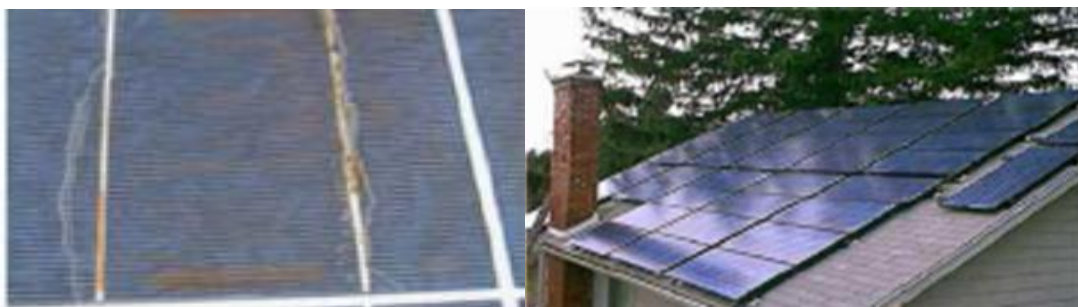
Figure (II.7) : Exemples de défauts rencontrés dans les générateurs photovoltaïques [26].
