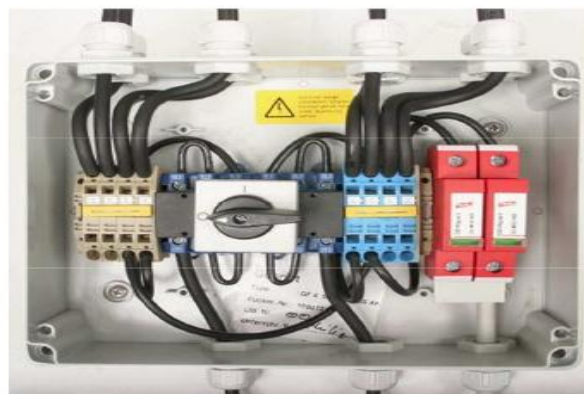
Figure (II.6): Exemple de boîte de jonction et câblage [30].
