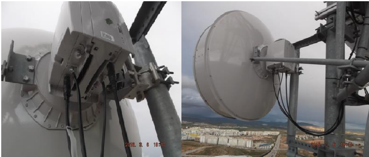
Figure II.7 Deux antennes installées en diversité de polarisation.
