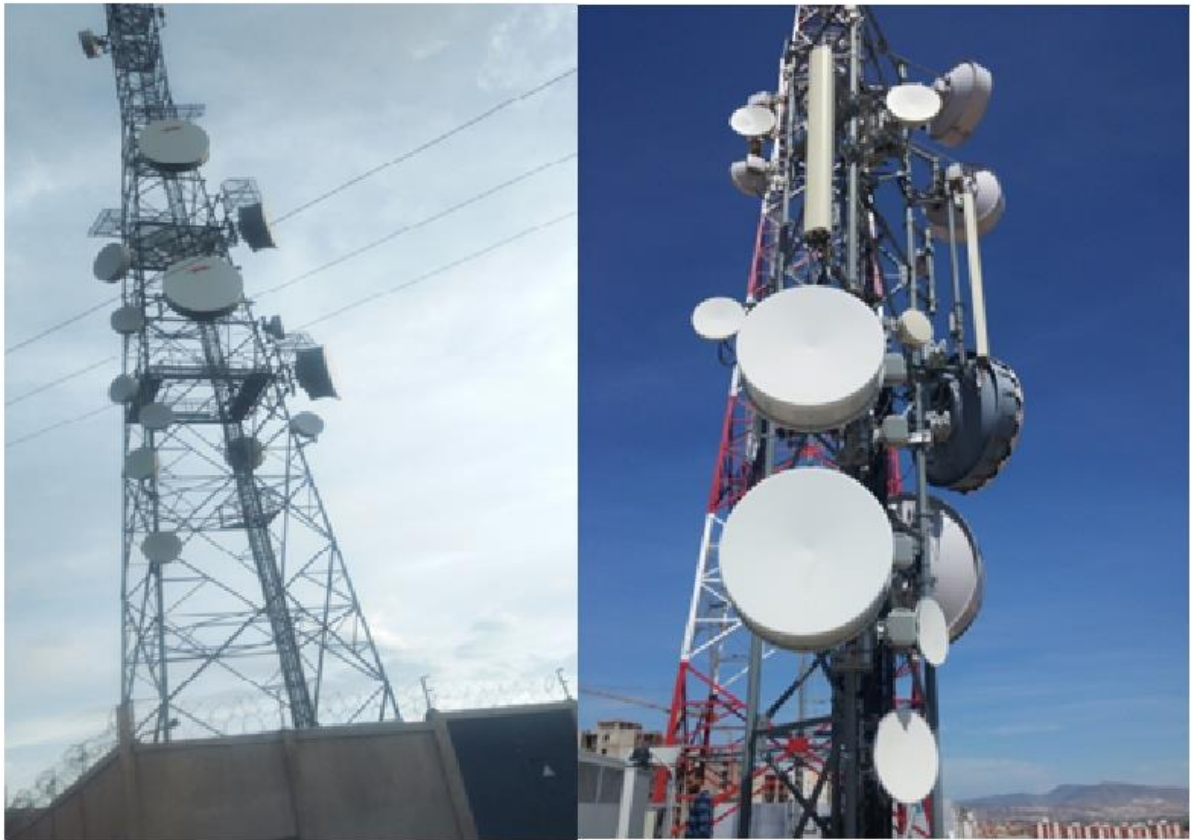
Figure II.6 Deux antennes installées sur chaque pylone pour établir une liaison FH en diversité d'espace entre deux sites GSM.
