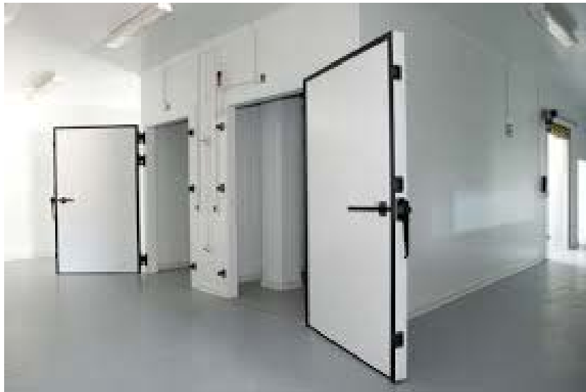
Figure (1.12) : Chambre froide
