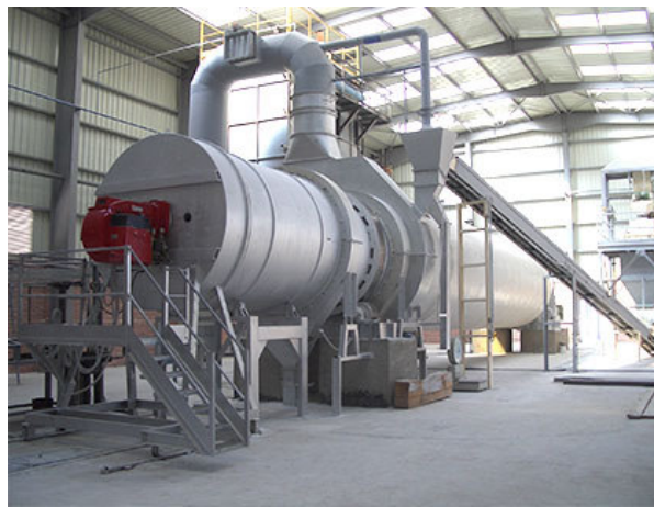
Figure I. 5 : Four de cuisson du gypse
