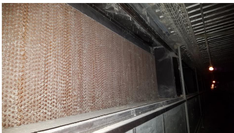
Figure 14 : Système d'humidification (pad-cooling). (Photo personnelle)
