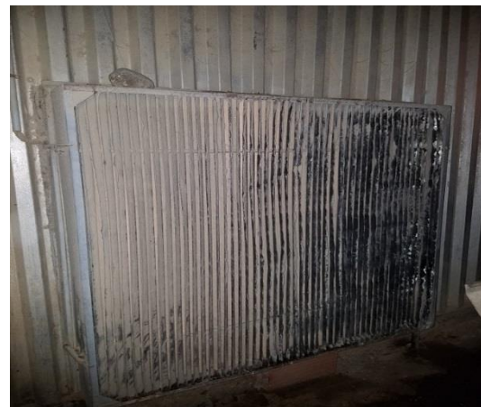
B : Vue intérieur d'extracteur du bâtiment.
