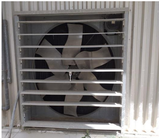
A : Vue extérieur d'extracteur du bâtiment.
