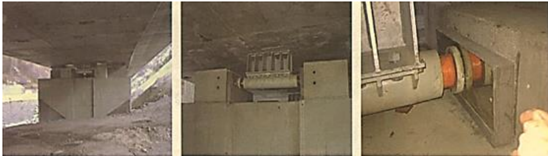
Figure 5.20 Dispositifs amortisseurs précontraints disposé transversalement sur piles
