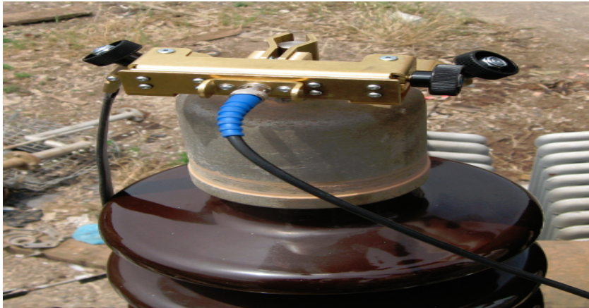
Figure III.11 : Raccordement de la pince pour borne de traversée au câble coaxial bleu.
