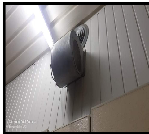
photo 06: le système de ventilation
