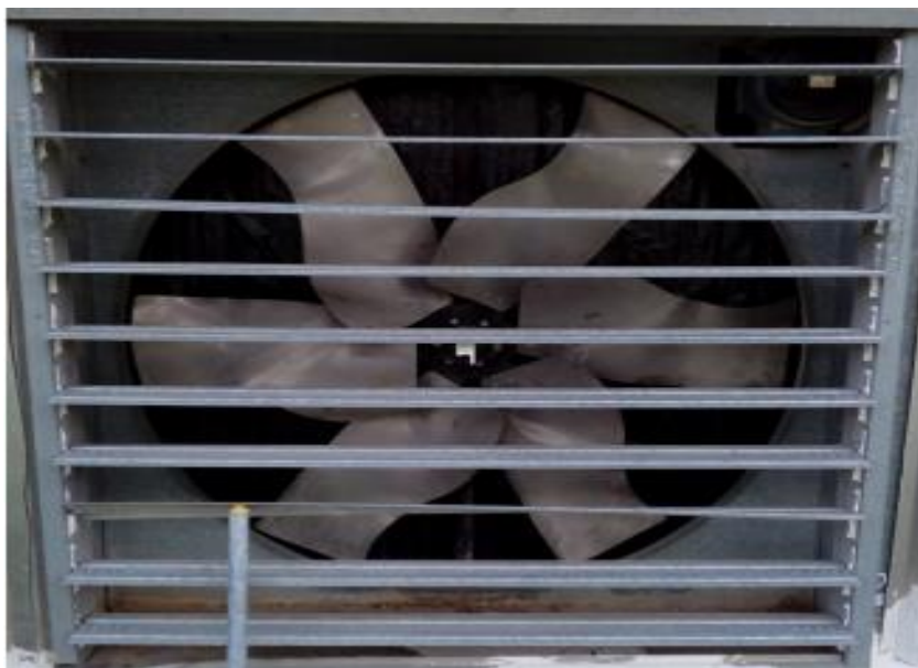
Figure 12 : Vue d'extérieure d'extracteur du bâtiment (Messili N, 2018)
