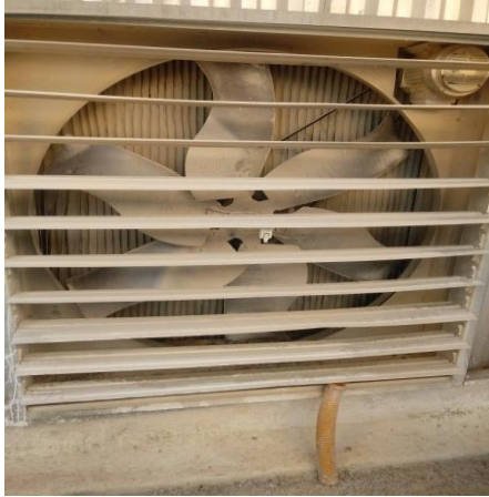
Figure 18: Ventilateur (Photo personnelle, 2020).
