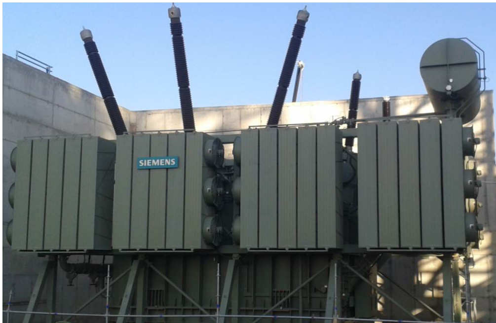
Figure I.1: Transformateur de puissance.
