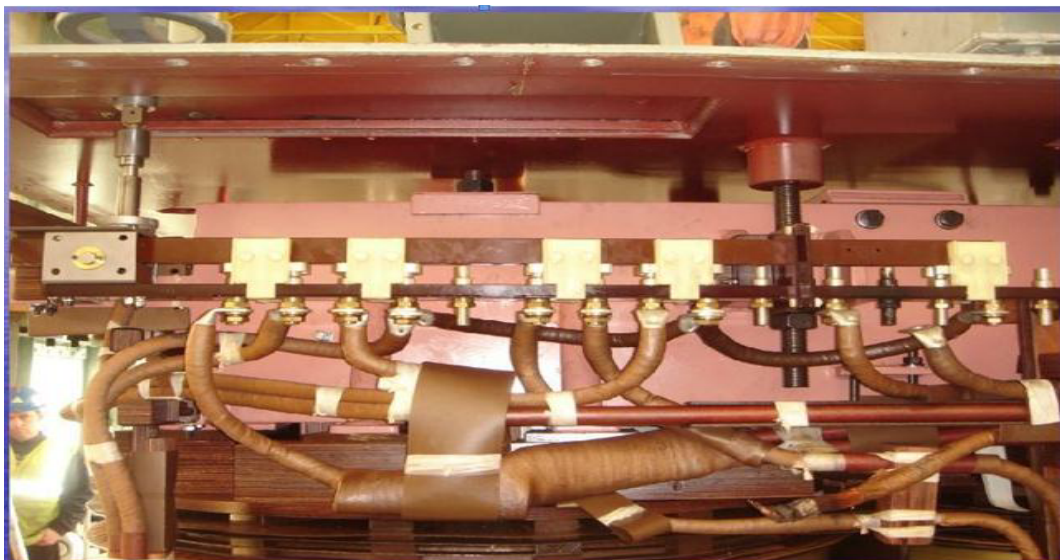
Figure I.9: Changeur de prise hors tension.
