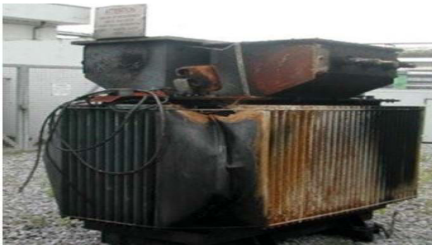
Figure IV.1: Conséquence des incidents électriques internes.
