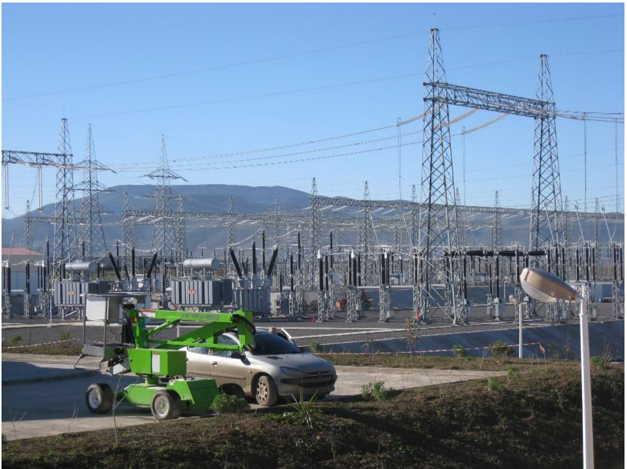
Figure 2.1: Poste 400/220KV BIR GHBALOU.
