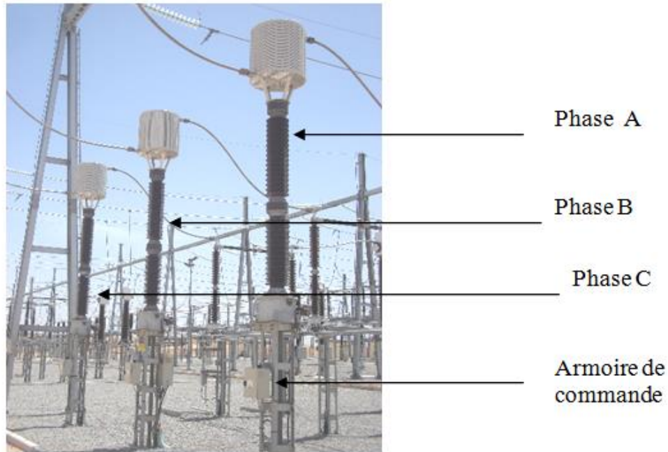
Figure 1. 13 Transformateur de tension (TT) installé sur une travée ligne au niveau du Poste BIR GHEBALOU
