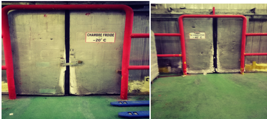
Figure 24 : chambre froid -20 C°. Figure 25 : tunnel de congélation -40C°.
