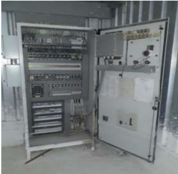
Figure 15 : Armoire de commande.
