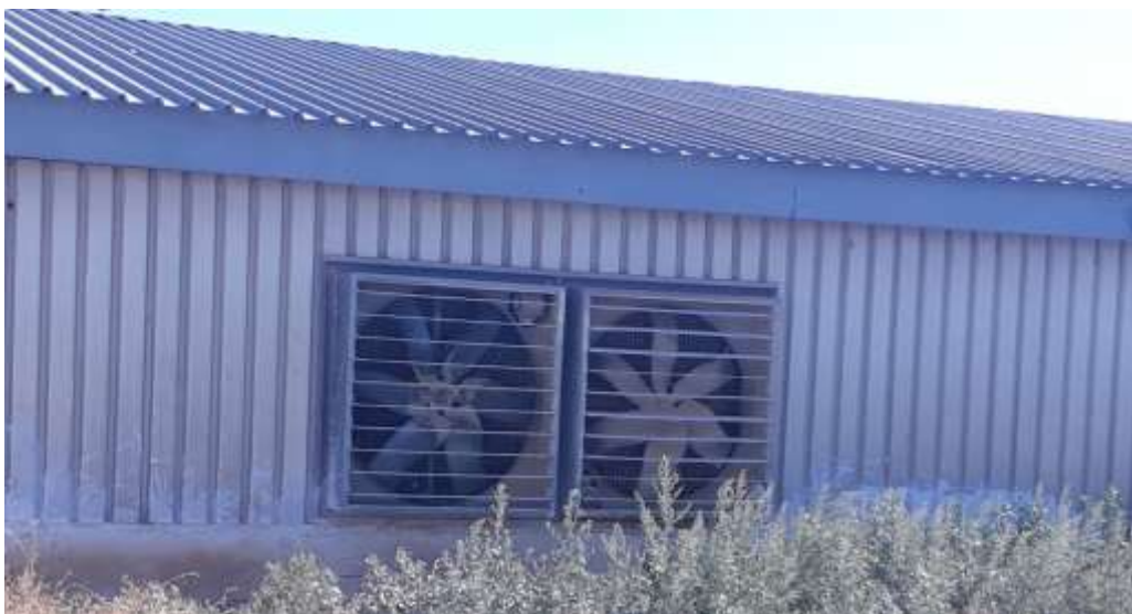
Figure 17 : Système de ventilation au niveau du CPN°02.
